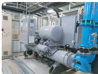
▲I棟新冰水主機
