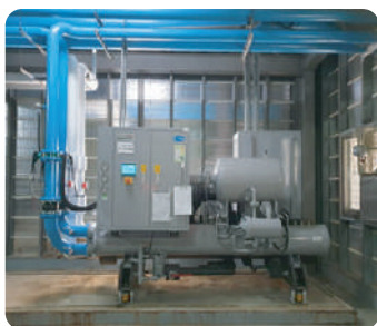
▲B棟新冰水主機
